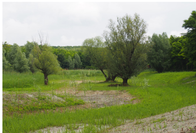
A sekély tározórészben az idős fűzfákat megkímélve zajlott a kivitelezés (Fotó: Kerpely Klára)
