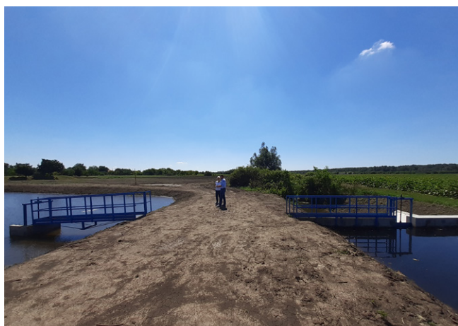
A Falusi belvízelvezető csatornán egy új műtárgy teszi lehetővé a medertározást (jobbra), és a visszatartott víz egy oldaltározóba (balra) kormányzását (Fotó: Farkas Viktor Mátyás)
